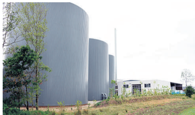
De tre akkumuleringsstanke ved Jelling Varmeværk har været proppet med varme fra solfangerne, så noget af det varme vand har været sendt retur til solfangerne for at blive afkølet i nattimerne. Foto: Leif Baun
